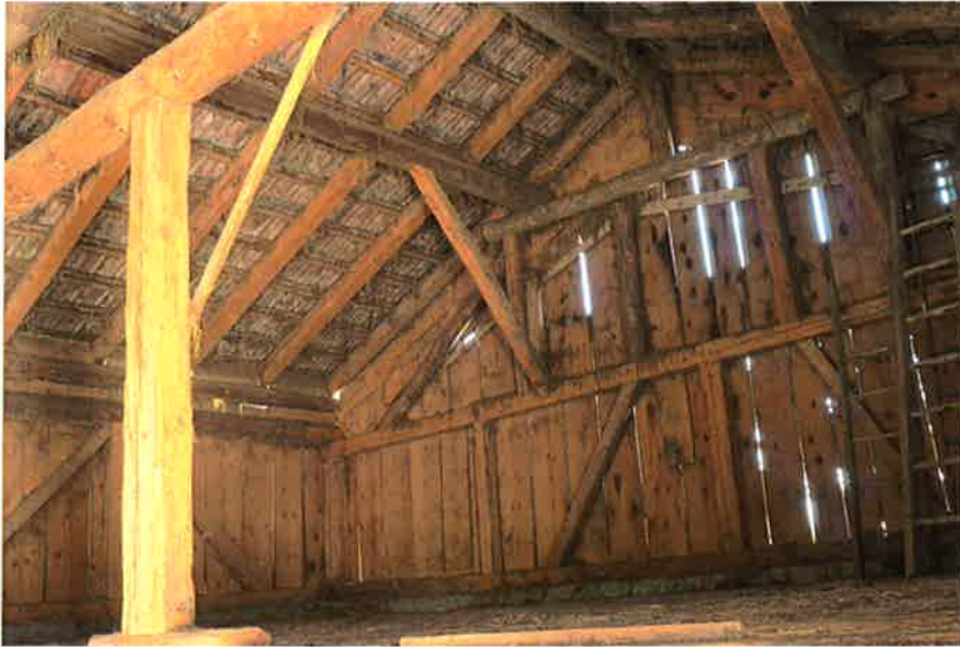
Abb. 13: Heuwalmen, Südwest- bereich: Konstruktion aus Rundhölzern, 1821; Wände 1. H. 20. Jh. [1941/47] mit mechanisch gesägtem Gebälk teils erneuert. Img 2014-06-10/767
