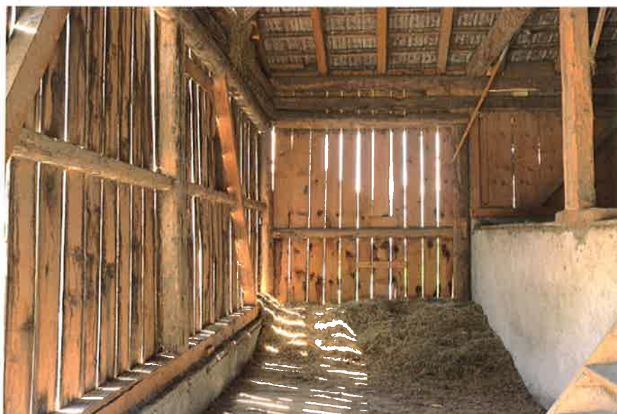
Abb. 12: Tenne, Südbereich: Wände teils in mecha- nisch gesägtem Gebälk erneuert, rechts der Stall, 1. H. 20. Jh. [1941/47]. Img 2014-06-10/766
